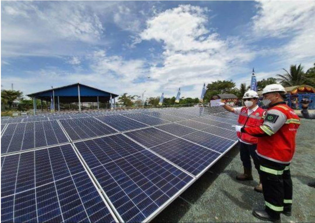
Gambar 7.2. Pembangkit Listrik Tenaga Surya (PLTS) terpusat
